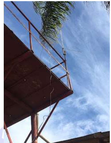
Antena DUAL instalada na subprefeitura
